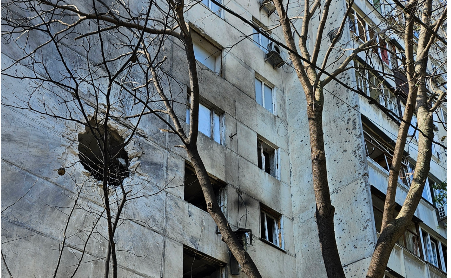
Багатоквартирний будинок, пошкоджений баражувальним боєприпасом в Одесі 7 вересня 2025 року.
